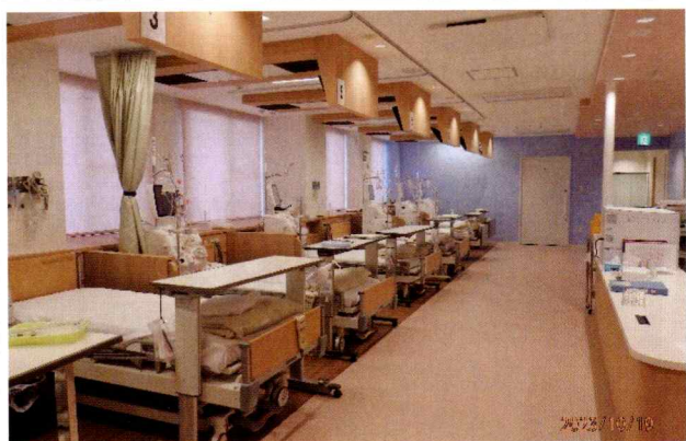
冷暖房の問題対策としてベッド上に輻射パネル設置
